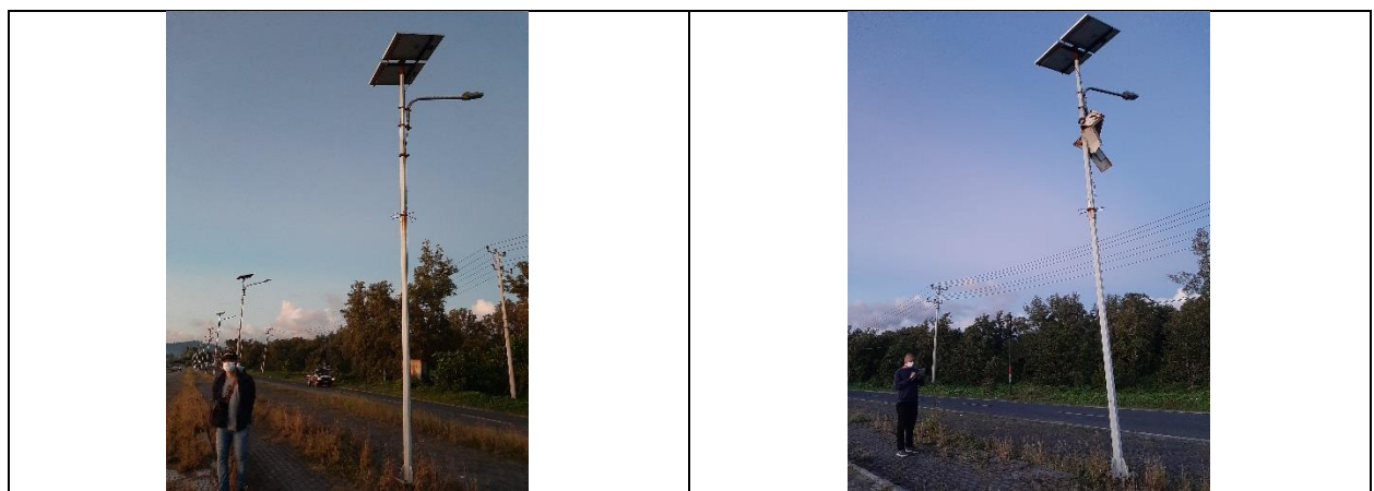
Gambar 3.1. Kondisi lampu jalan di area “K”.
