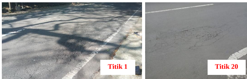
Gambar 15. Kerusakan Permukaan Arah Kota Cimahi – Kab. Bandung Barat
