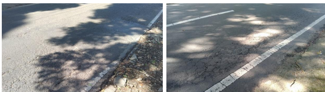
Gambar 16. Kerusakan Permukaan Arah Kota Cimahi - Kab. Bandung Barat
