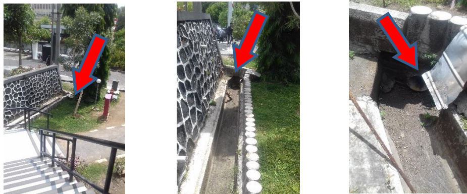
Gambar 6. Saluran Drainase yang menggunakan pipa 3"
