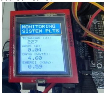
Gambar 9. Monitoring output system PLTS di lokasi PLTS terpasang
