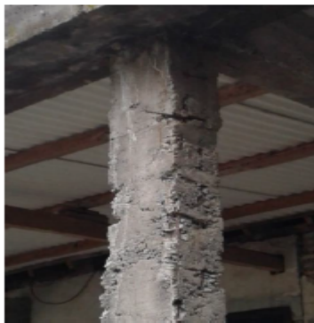
Gambar 4. Material Beton Bermutu Rendah (Winarno, Kurniawardhani dan Singgih, 2021)
