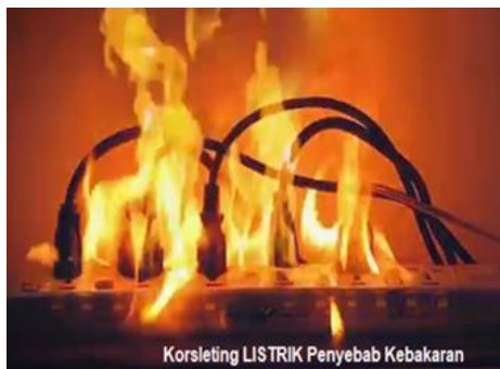
Gambar 5. Stop kontak yang terbakar
