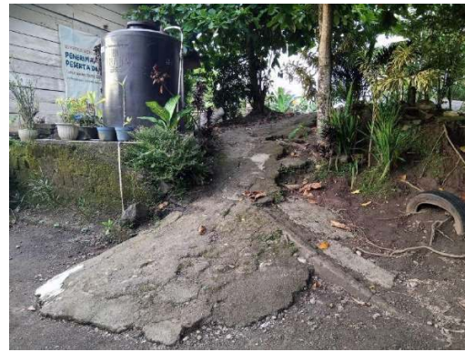
Gambar 2. Kondisi Jalan Masuk Sekolah
